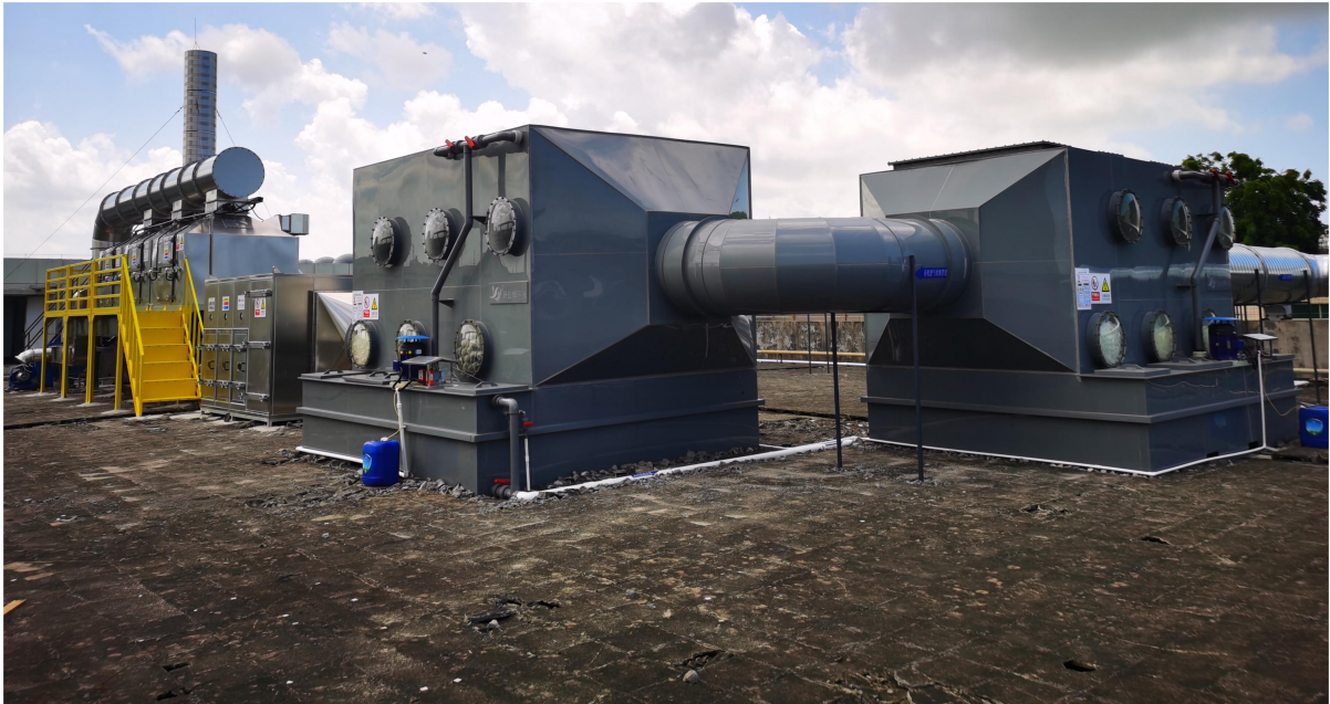
有机废气净化治理设施（FQ-001）
